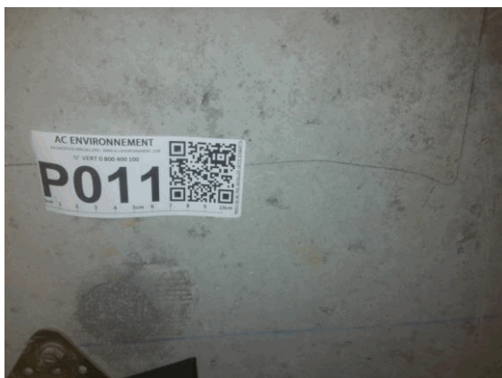
002SB001743-1 n°11 - 1 (P11) - Machinerie - Vol 7 (Machinerie ascenseur)
