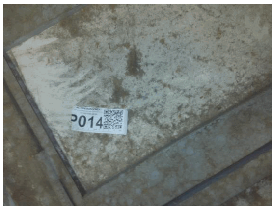
002SB001743-1 n°14 - 1 (P14) - Machinerie - Vol 7 (Machinerie ascenseur)
