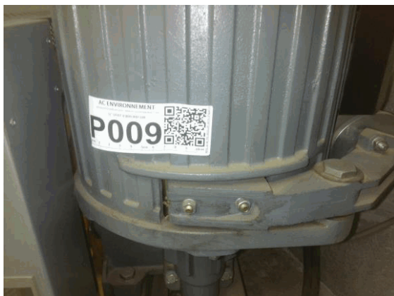
002SB001743-1 n°9 - 1 (P9) - Machinerie - Vol 7 (Machinerie ascenseur)
