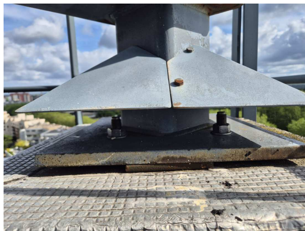
Fig. 26 — Contre-écrou manquant sur les platines de base
