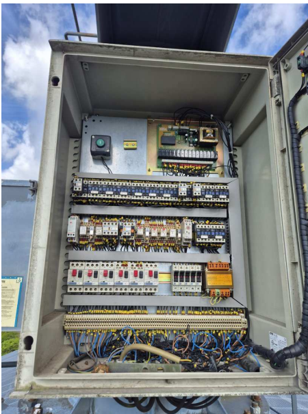
Fig. 19 — Coffret de commande — cartes électroniques obsolètes
